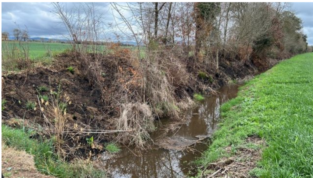
Figura 24. Canal de drenatge C després d'un episodi de pluges. S'indica el punt de rebaix de la mota.
